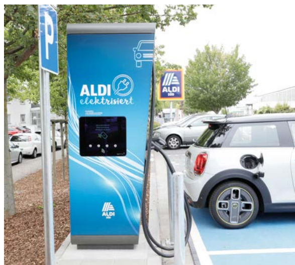
Abbildung 14: Klimafreundlich Strom tanken: Entweder von der PV-Anlage auf dem Filialdach oder 100 % Grünstrom aus Wasserkraft
